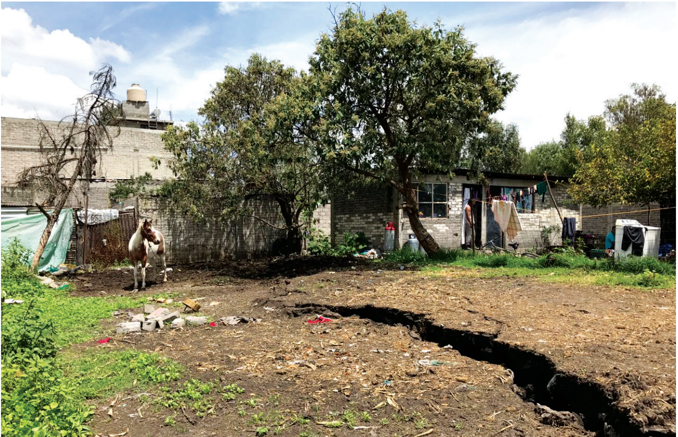
Grieta en suelo y viviendas de la zona chinampera de San Gregorio Atlapulco. Septiembre 22, 2017. Fotografía: Marisa Mazari Hiriart.
